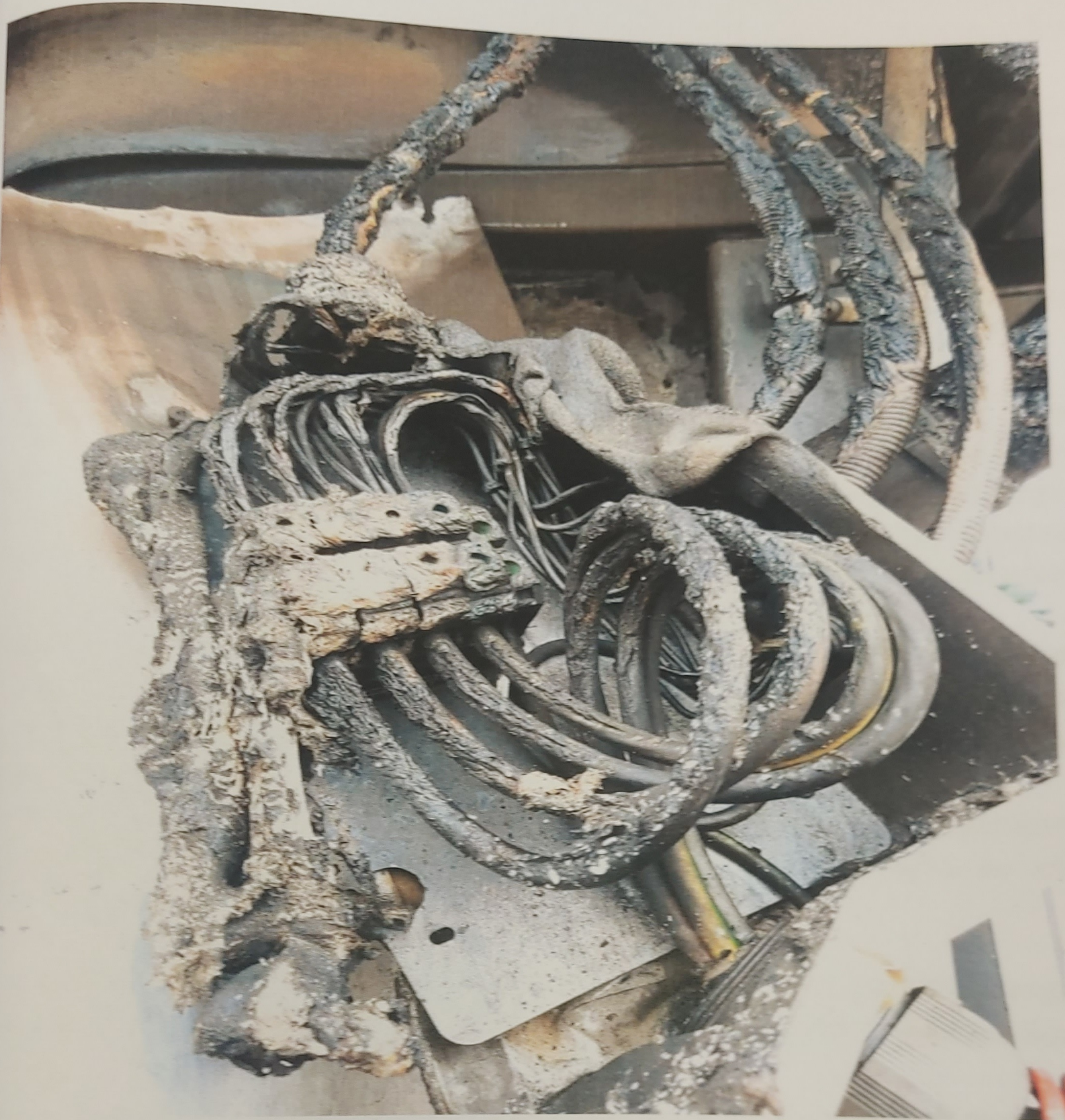
Слика 2. Изглед на опожарените проводници во пластична разводна кутија
